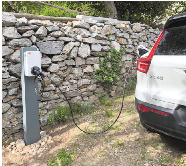
Bereit für die bevorstehende Elektrifizierung der Strasse?
